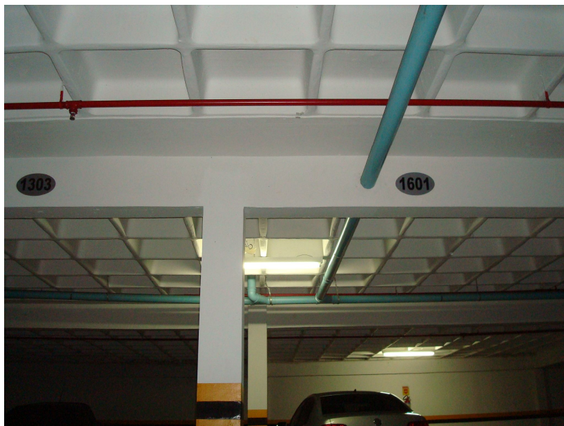
Figura 6 – Passagem de tubulação através de furos em vigas
