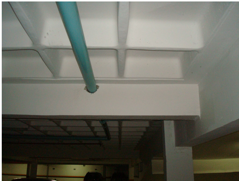
Figura 5 – Passagem de tubulação através de furos em vigas
