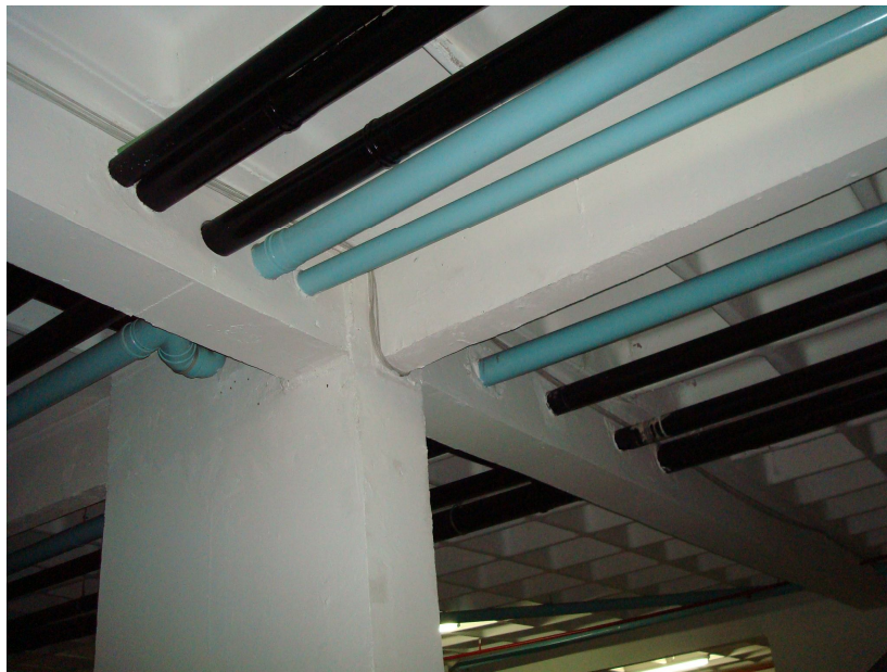
Figura 7 – Passagem de tubulação através de furos em vigas
