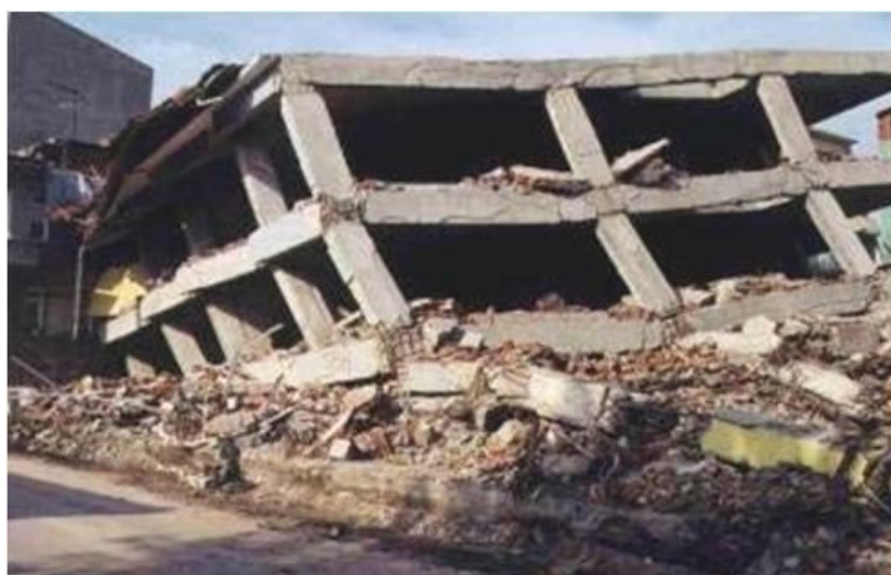
Figura 2 - Estrutura de concreto após abalo sísmico (Rodrigues:2006)
