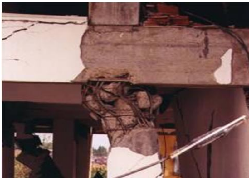
Figura 3 - Estrutura de concreto após abalo sísmico (Rodrigues:2006)
